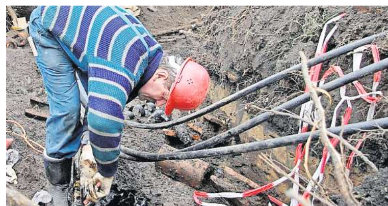
Nicht nur die Elektroverkabelung, auch die rechtliche Lage drumherum war in Kyritz lange Zeit kompliziert. ARCHIVFOTO: ALEXANDER BECKMANN
